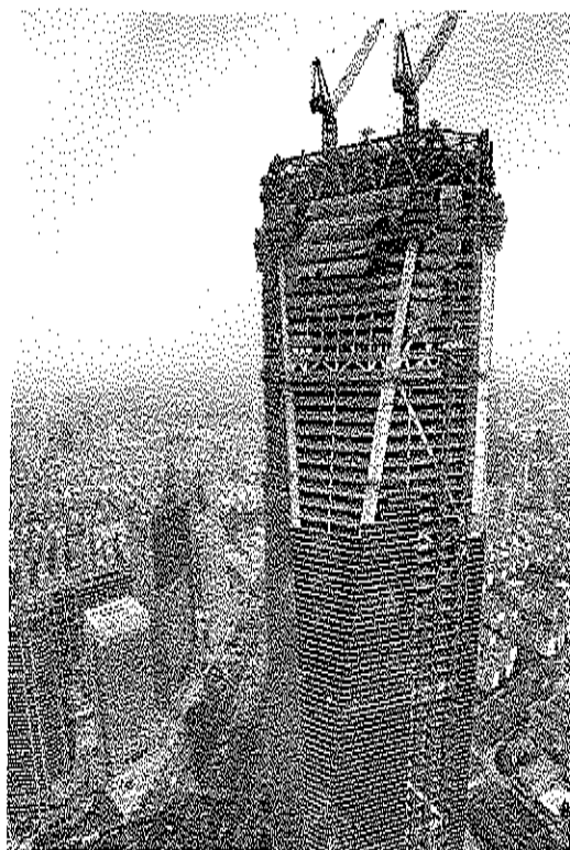
4/ Kohn Pedersen Fox, Shanghai World Financial Center , Shanghai, 2008. Foto di cantiere: in evidenza le superstrutture stabilizzanti (super-colonne, super-diagonali) di connessione tra i piani.
